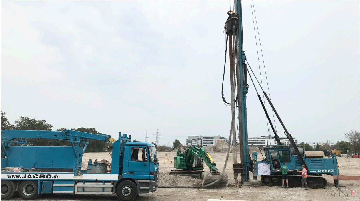
Für das Fundament des neuen Marktes werden derzeit Bohrungen im Untergrund durchgeführt. (Bildnachweis: Globus SB-Warenhaus)
